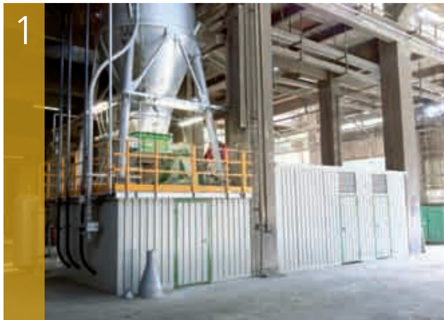
1. L'IMPIANTO DI GUIDONIA THE GUIDONIA PLANT
